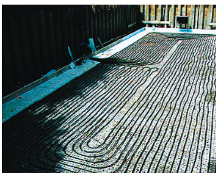
Wärmetauschersystem in einer Energiebodenplatte.
